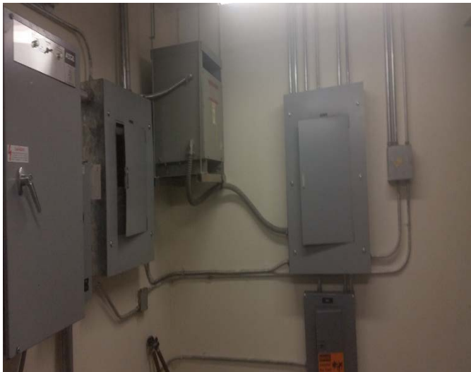
Electrical panels on 1 st floor of OCH
